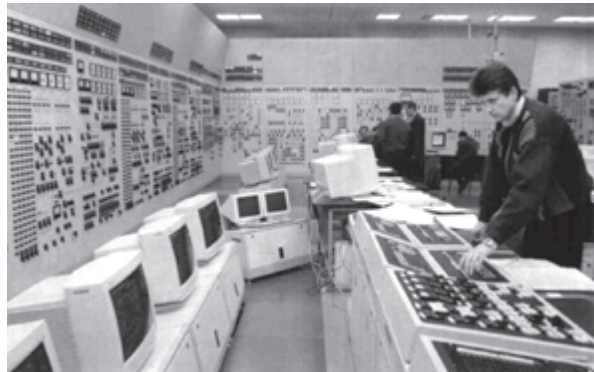
Щит управління енергоблоку АЕС
